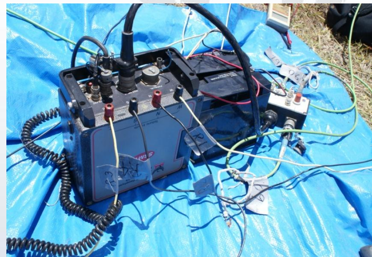
Estación de MT instalada y funcionando
